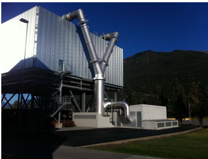
Stazione di pompaggio
