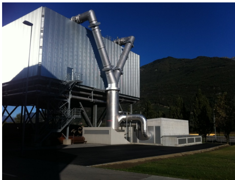
Stazione di pompaggio
