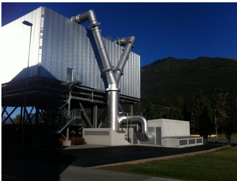
Stazione di pompaggio
