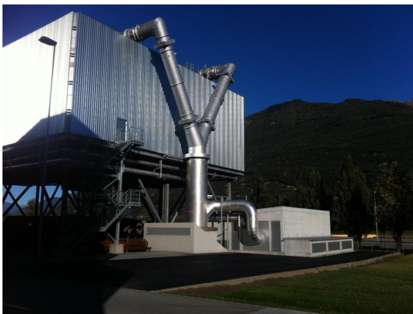
Stazione di pompaggio
