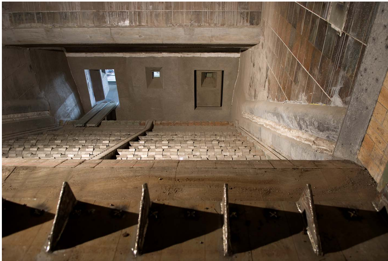
Camera di combustione
