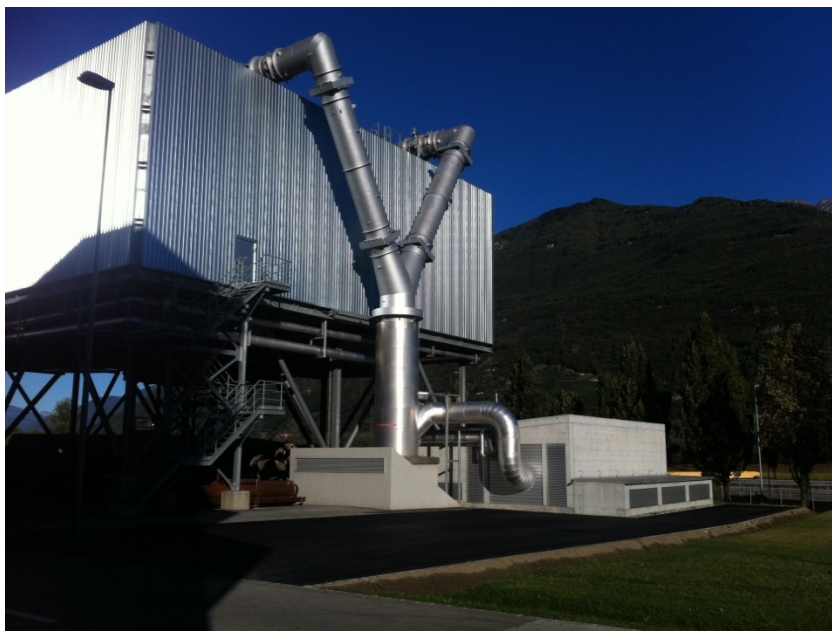
Stazione di pompaggio
